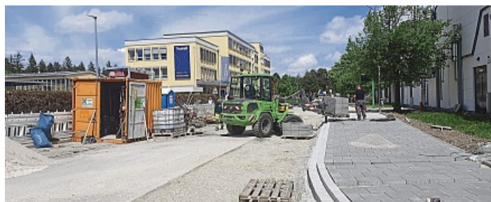
Hier tut sich einiges: An der Blumenstraße ist die Sanierung der Ortsdurchfahrt in vollem Gange. Auch einen neuen Gehweg gibt es. STADT GERETSRIED
